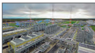
Компрессорная станция г. Выборг
