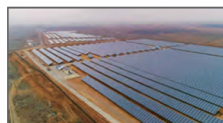
Солнечная электростанция Астраханская обл.
